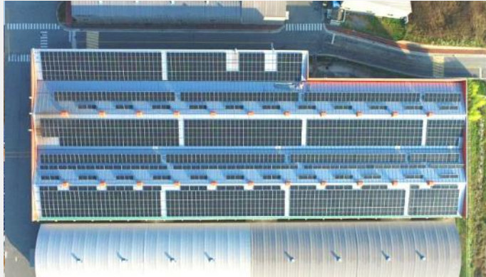
DSC 아산2공장 태양광발전소 (충남 아산)
